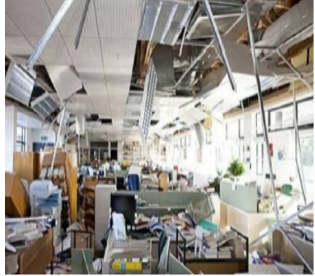
Şekil 2- Deprem sonrası operasyon özelliğini kaybetmiş ofis binası
